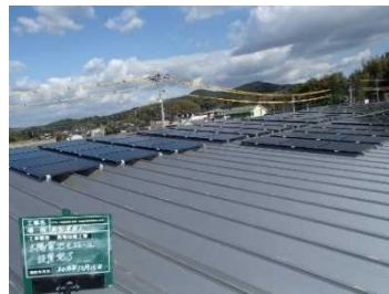
太陽光発電モジュール
