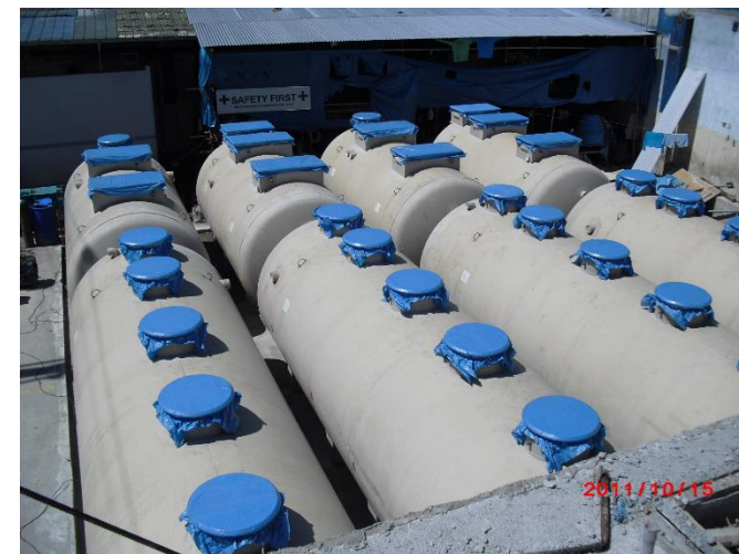
住宅地 (フィリピン: 2,050人槽)
