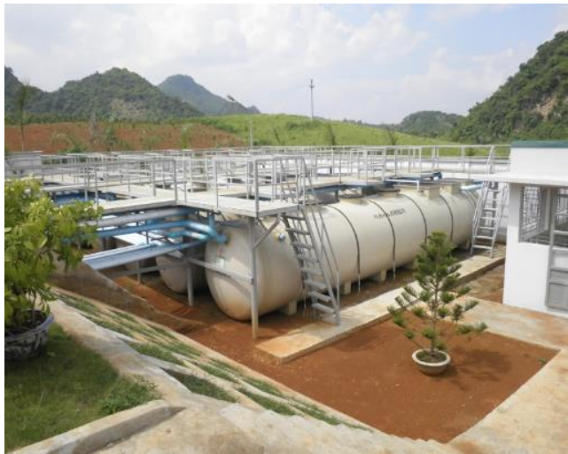
病院 (ベトナム: 1,250人槽)
