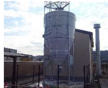
燃料タンク 二光エンジニアリング社製 FTC - 5 FRP製 9.8m 3
