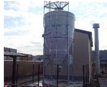
燃料タンク 二光エンジニアリング社製 FTC - 5 FRP製 9.8m 3
