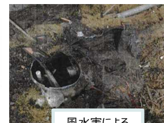
風水害による 破損のリスク
