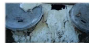
老朽化している単独 処理浄化槽
