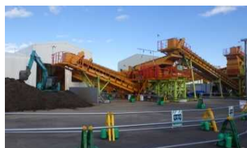
檜葉町の仮置場内破碎選別設備
