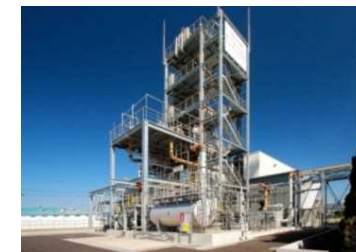
有害化学物質の放出を抑制可能な二酸化炭素分離回収設備
