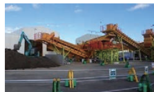
楢葉町の仮置場内破碎選別設備
