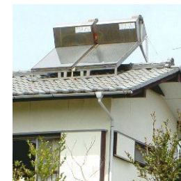
↑太陽熱利用システム
