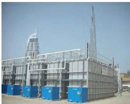
処理プラント
