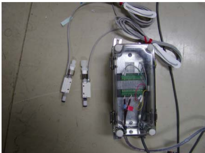
図17 空気取り入れ口 防水ボックスの中に計装アンプを固定してある。
