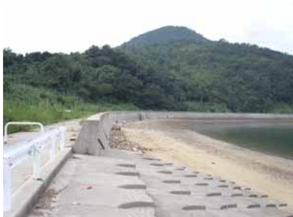
撮影方向②の海岸の状況（ズーム）
