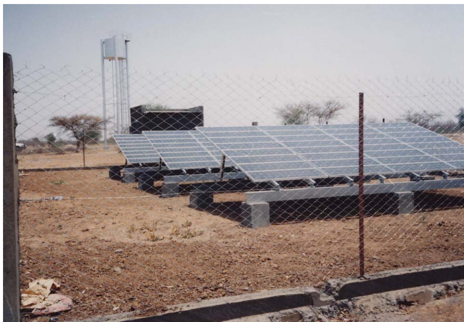
Photo 7.1: Installation de production d'énergie électrique utilisant l'énergie solaire pour le pompage
