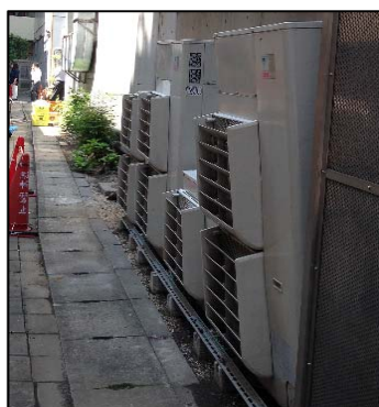
倒れそうな室外機
