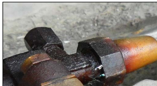
フレア継手部の劣化
