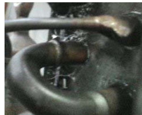
⑫ 蒸発器と凝縮器のUベンド部
