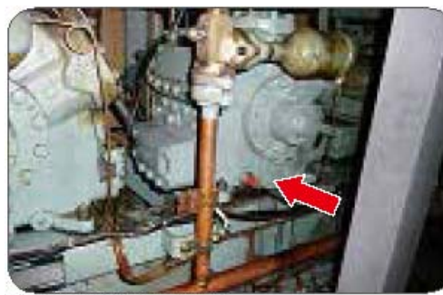
圧縮機周辺の油のにじみの確認
