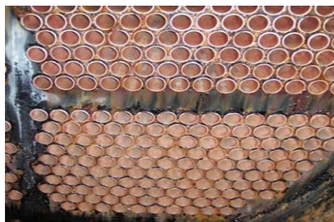
水冷熱交換器伝熱管の劣化
