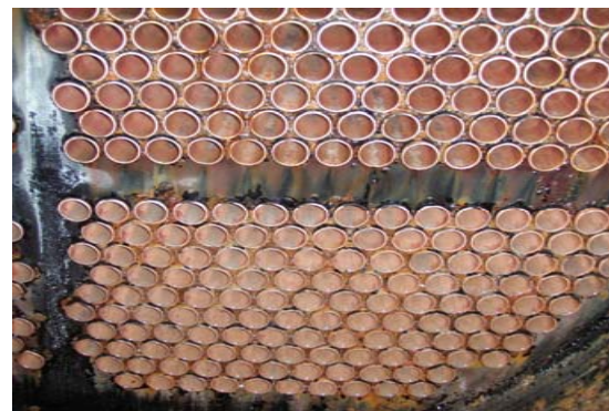
水冷熱交換器伝熱管の劣化
