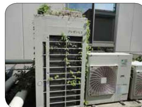
草で覆われた室外機
