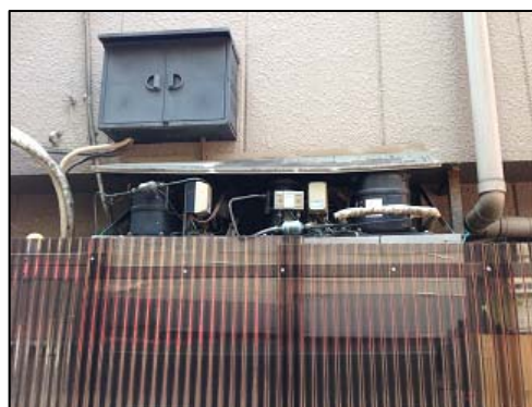
雨ざらしの室外機
