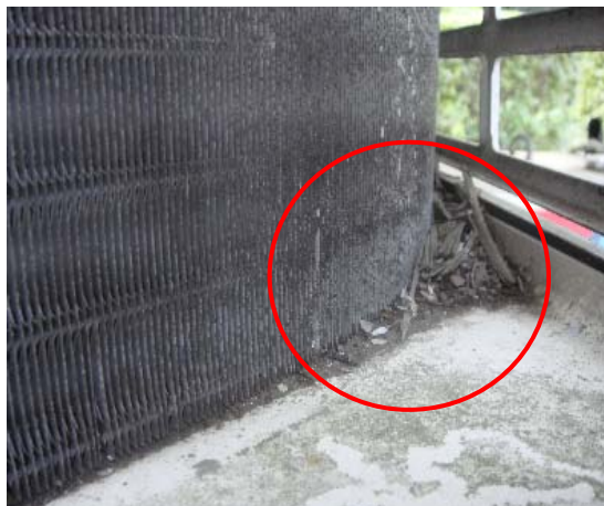
⑧ 空冷凝縮器
