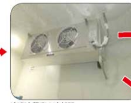
冷凍冷蔵庫の冷却器
