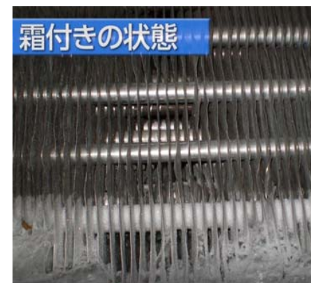
ショーケースの熱交換器点検
