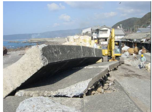
図 5-3 高知県 なばえ 菜生海岸の被災 （写真提供：福濱方哉 国土交通省北陸地方整備局黒部河川事務所長）
