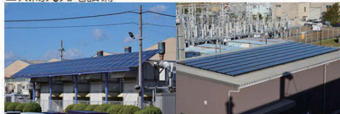
■太陽光発電設備
