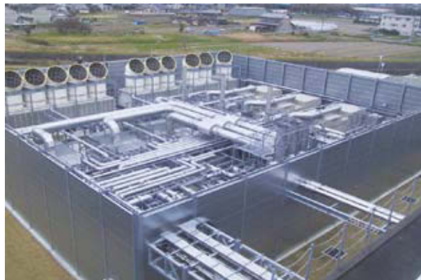
コージェネレーションシステム
