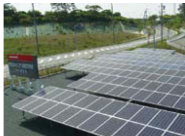
太陽光発電設備
