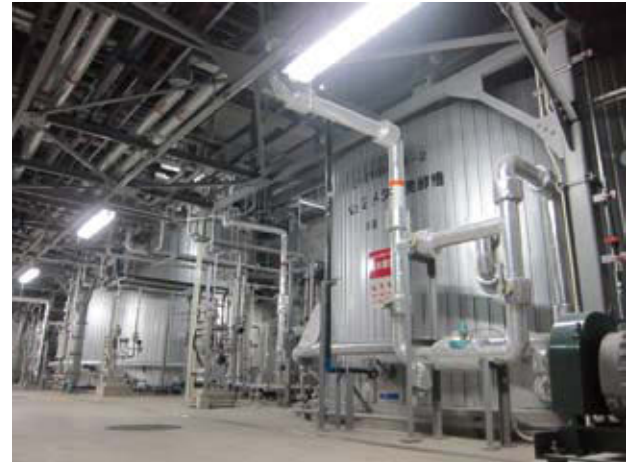
バイオガス設備 (あべのハルカス)
