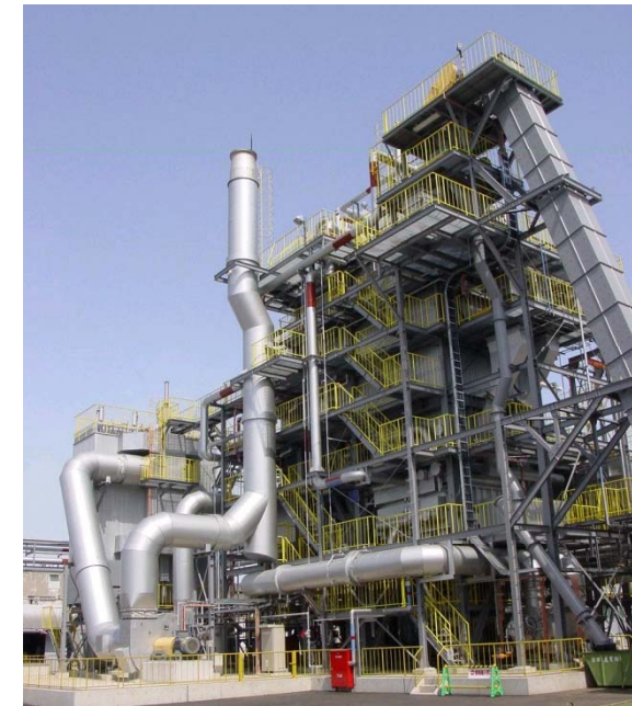
ボイラー本体(中央奥) 燃料供給コンベヤ(右上) バグフィルター(左奥) 通風機(左下)
