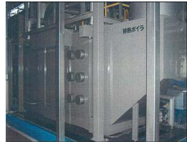
1.5t/h 排ガス蒸気ボイラ
