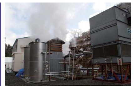
松之山温泉に設置された実証システム
