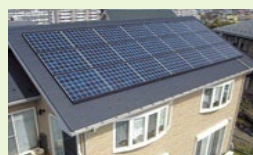
太陽光パネル
