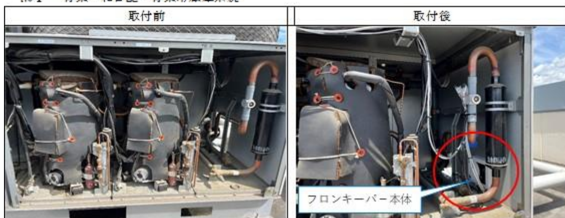
図 2.1-7 検知システム設置前後の写真5
