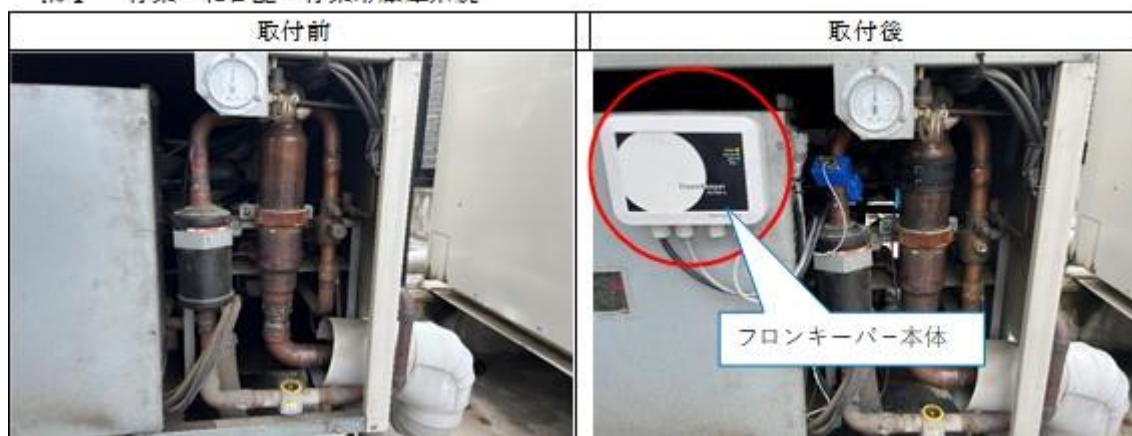
図 2.1-6 検知システム設置前後の写真4
