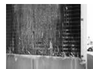
室外機の腐食
