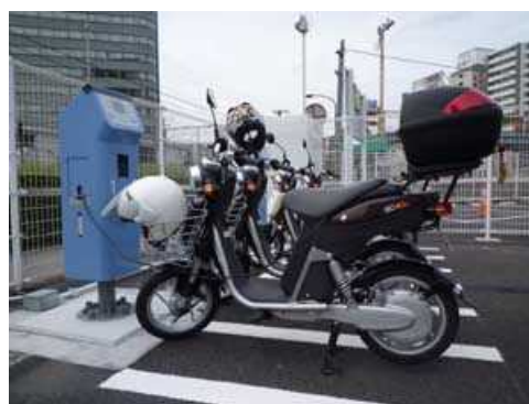
写真 駐車場への充電設備設置の例（日本）
