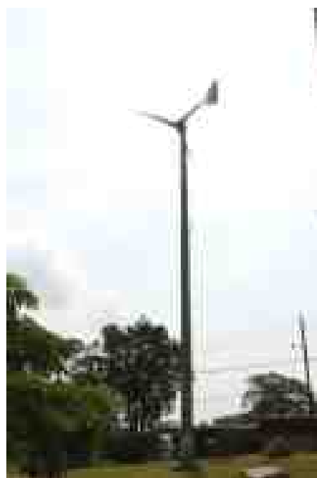
風力発電装置
