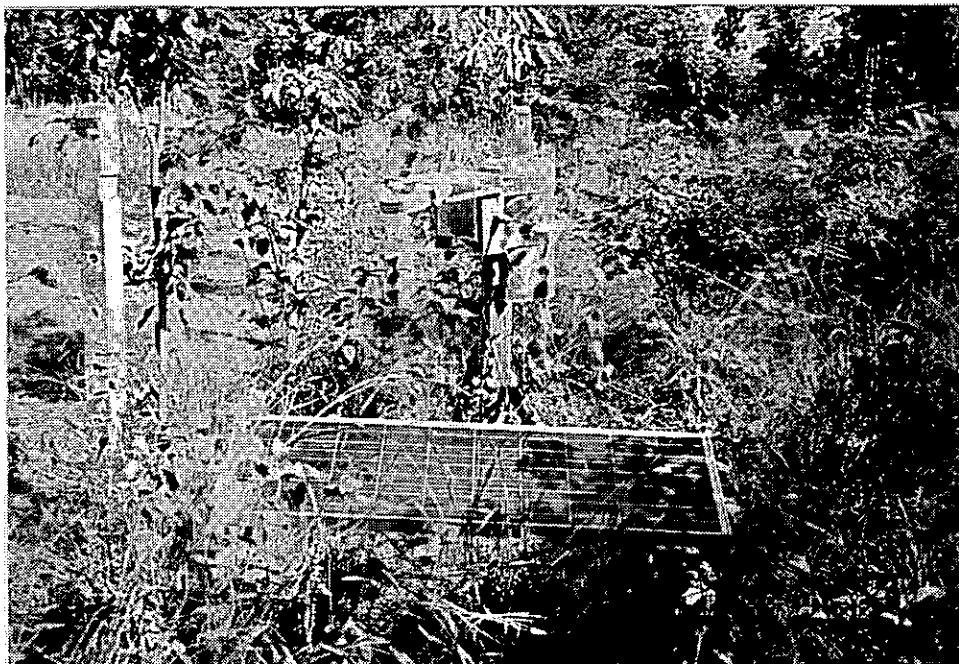
写真 3.2 ソーラーシステムによる自動雨水採取装置
