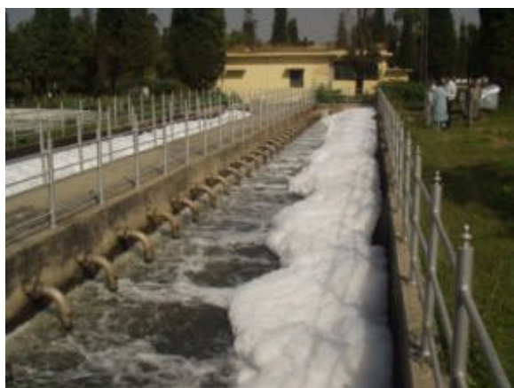
エアレーション状況
