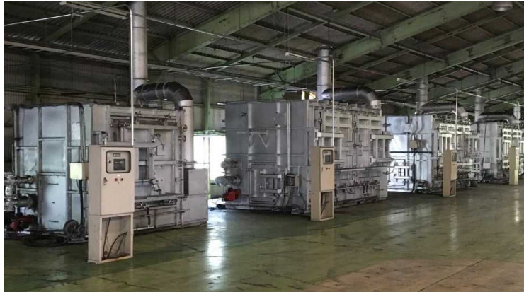
一次処理装置
