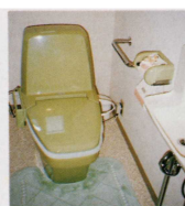
水洗化されたトイレ
