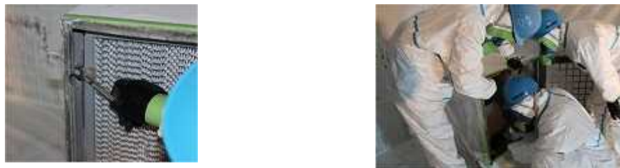
図 3.39 HEPAフィルタの留め付の緩み点検
