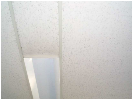
図 3.106 石綿含有ロックウール吸音天井板
