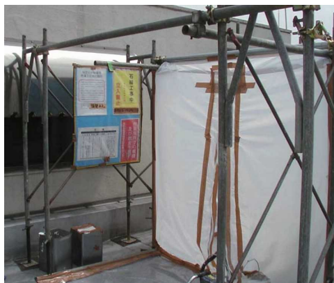
図 3. 44 セキュリティゾーン前に設置した石綿 障害予防規則に基づく表示及び掲示
