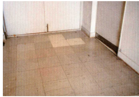
図 3.107 石綿含有ビニール床タイル
