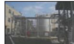
BDF製造設備
