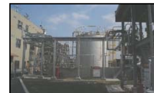
BDF製造設備
