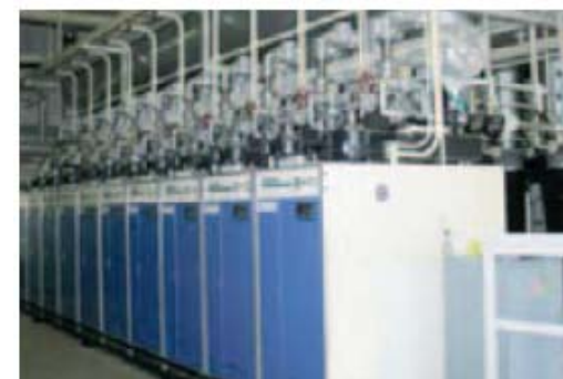
多数の小型ボイラーを設置し、 負荷に併せて運転台数を管理
