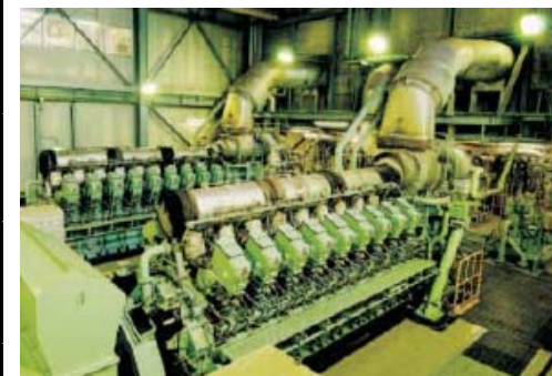
コジェネレーションシステム
