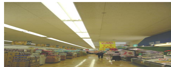
店内／バックヤード照明系統
