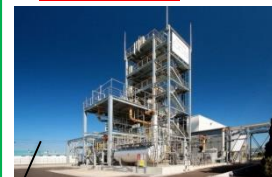
二酸化炭素分離回収設備
