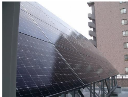
太陽光発電設備
