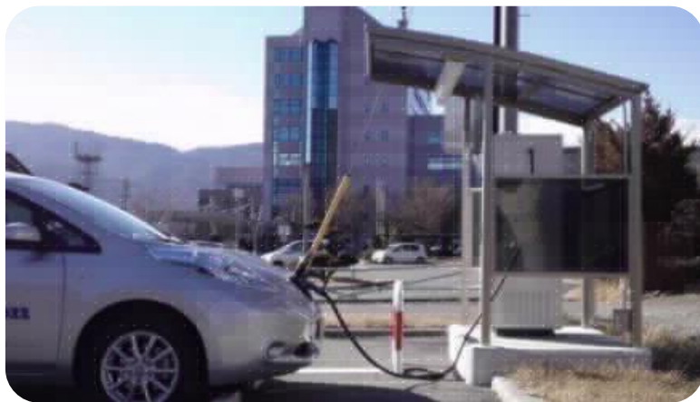
（EVと充電設備）
