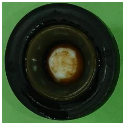
写真-3-3 弁体の付着物の状態（呼び径20 No.2）
