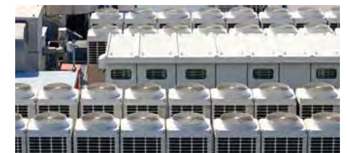
大気中に熱を放出する空気熱源ヒートポンプ
