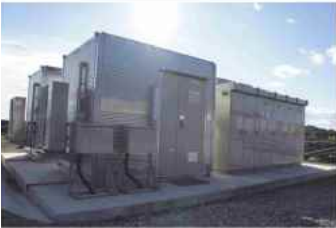
非常用電源を備え災害時に電力を供給できる仕組みを構築
