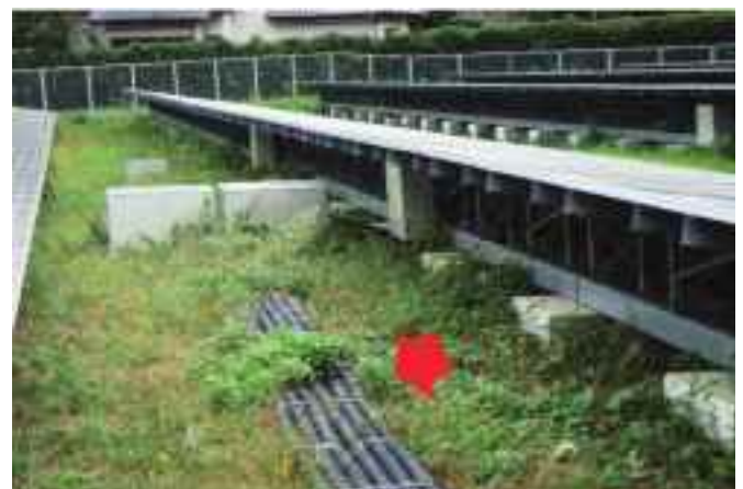
埋立物に影響を及ぼさないよう配線を地表設置のチューブ内に格納
