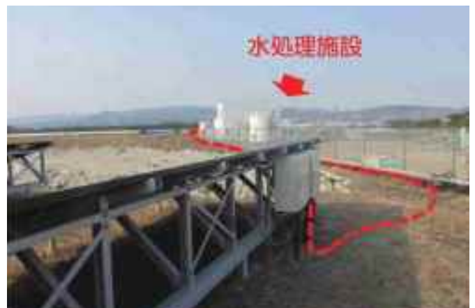
地下埋設されたケーブルにより発電した電気を水処理施設に送電
