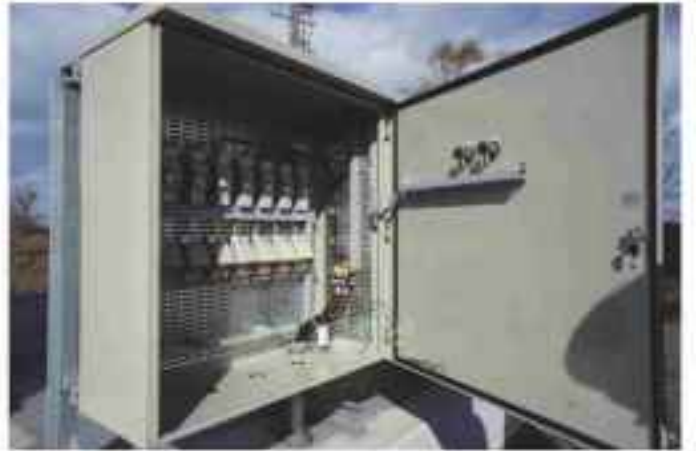
非常用電源を備え災害時に電力を供給できる仕組みを構築
