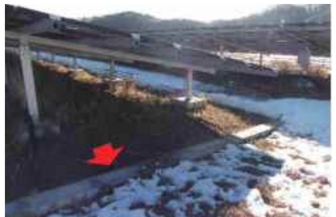
配線の劣化防止や県職員の維持管理作業効率向上のため配線を蓋付U字溝に収納
