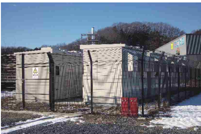
埋立物への影響を考慮し、キュービクル(パワーコンディショナ)を埋立地外に設置
