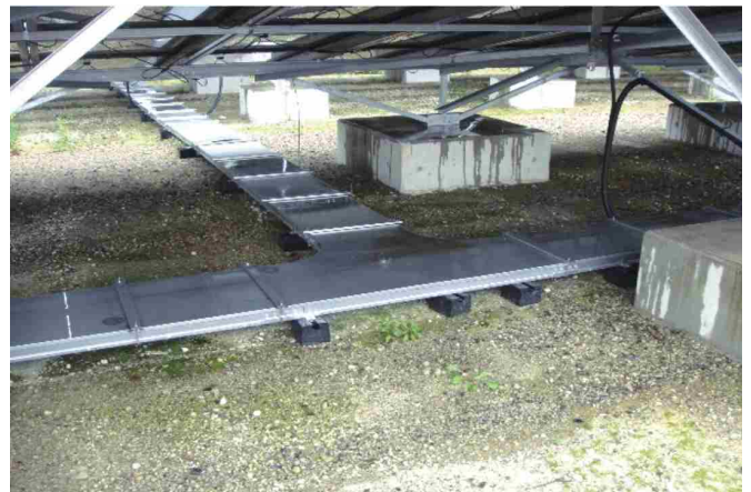
埋立物に影響を及ぼさないよう、配線の埋設を避け地表の専用ケースに格納
