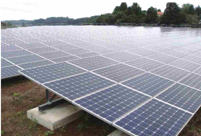
風の影響を考慮しパネル角度を10°に設計(大崎太陽光発電所)
