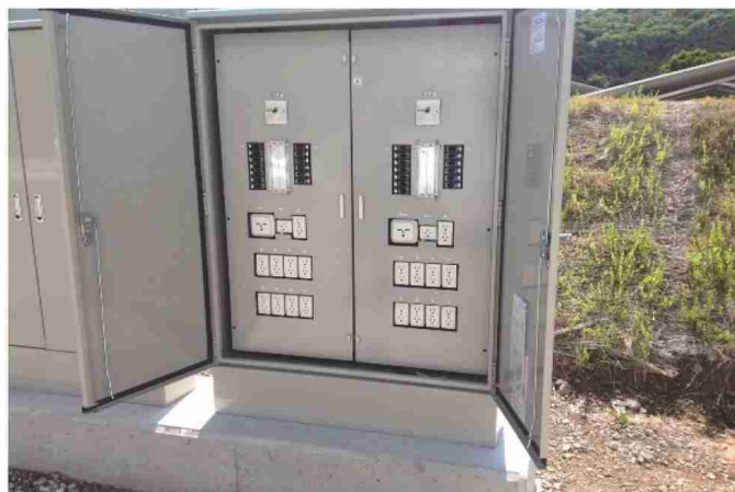
非常用電源を備えて災害時に電力供給ができる仕組みを構築
