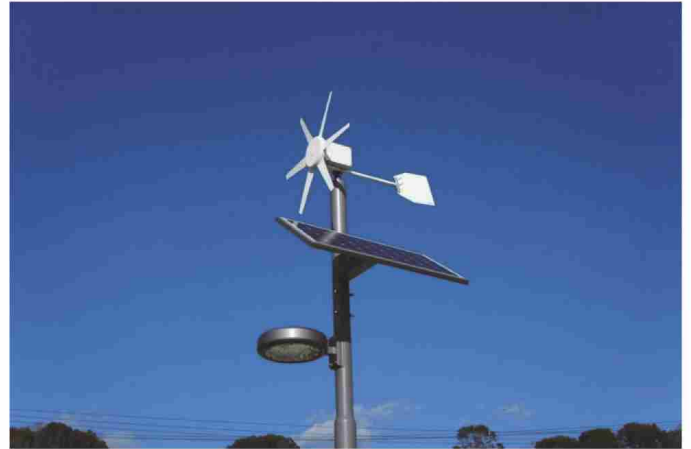
ハイブリッド防犯灯(3基)を設置
