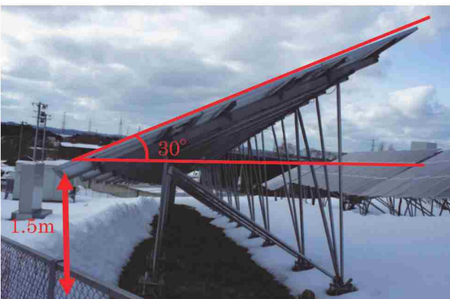
積雪対策としてパネル設置高を最低1.5m、パネル角度を30度で設置
