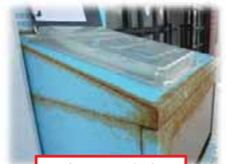
ボックスの損耗
