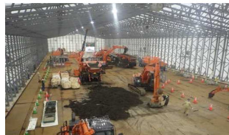
再生資材化プラント
