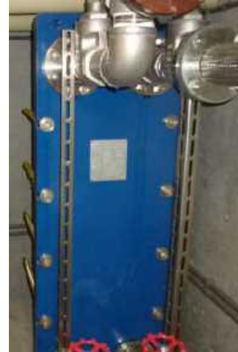
写真 2 熱交換器イメージ (参照：箱根大平台温泉組合調査写真)
