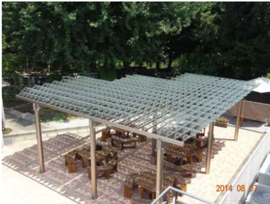
図 42 エアリーシェードの施工時例 出所) 積水化学工業株式会社
