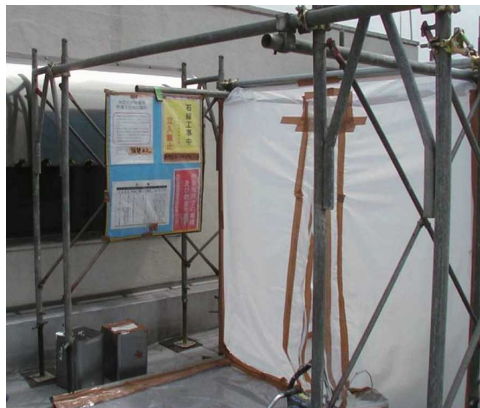
図 3. 44 セキュリティーゾーン前に設置した石綿 障害予防規則に基づく表示及び掲示
