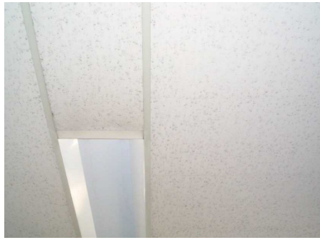
図 3.106 石綿含有ロックウール吸音天井板
