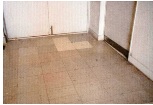
図 3.107 石綿含有ビニール床タイル
