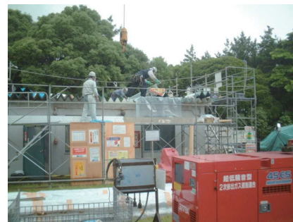
図3.104 折版をはがしているところ
