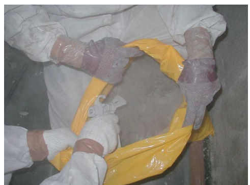
図 3.67 袋詰めした石綿廃棄物への粉じん飛散防止処理剤を散布
