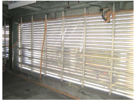
図 3.38 外壁の隔離例（ガラスの手前をプラスチックシートで隔離）
