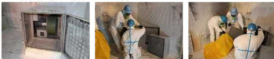
図 3.40 HEPAフィルタの交換
