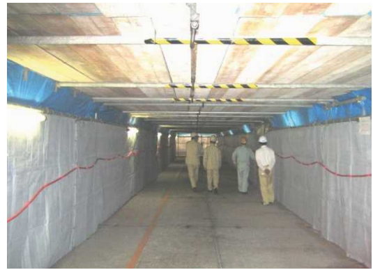
図 3. 14 駐車場ビルにおける施工区画(車路の両側及び上部吊足場が施工区画)
