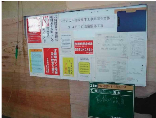
図 3.87 屋外蒸気配管用における掲示
