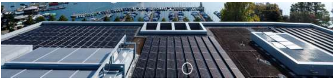
図 15-4 スイス・リーチューリッヒ本社屋上の太陽光発電装置。
