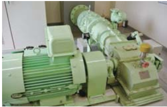
マイクロ水力発電設備 (横軸クロスフロー水車)
