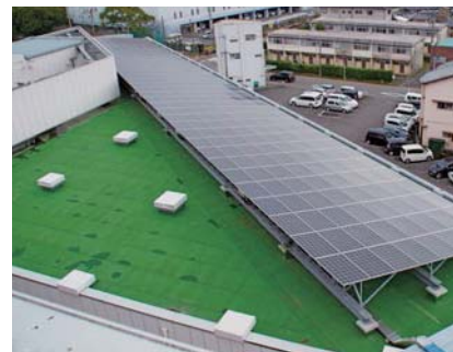
屋上のスペースを有効活用して設置
