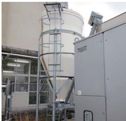
サイロには木質ペレット約1カ月分の使用量が入る
