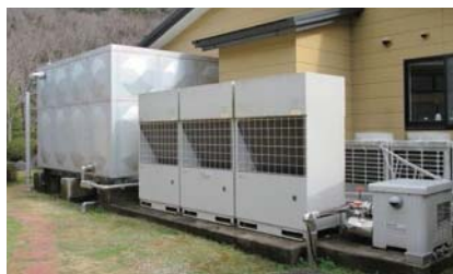
エコキュート設備。奥からタンク、ユニット、加圧ポンプ
