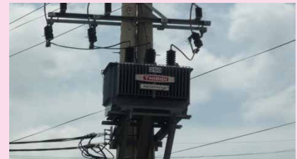
高効率変圧器（ベトナム）
