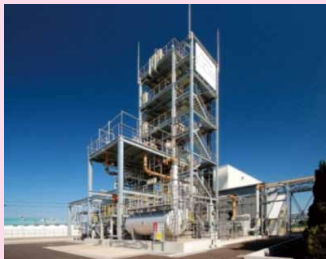
石炭火力発電所に設置された二酸化炭素分離回収設備
