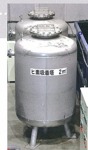
さらなるヒ素吸着除去を行い、地下水の処理が完了します。
