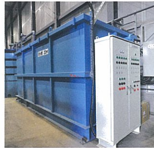
揚水井戸で汲み上げ、送り込まれた地下水を溜める水槽です。
