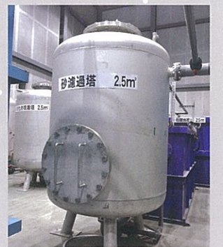
沈降分離槽の上澄みをろ過し、細かい粒子を取り除きます。
