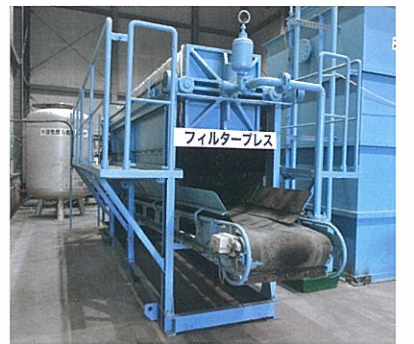
スラリー槽に溜められた汚泥を脱水し、固形化する設備です。ケーキ状に固められた汚泥は、適正に処分されます。
