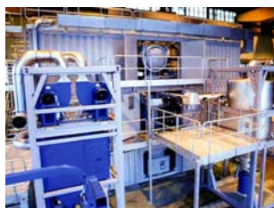
無害化処理に使用する加熱燃焼炉とその付帯設備
